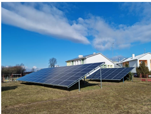
Instalacja fotowoltaiczna wykonana na potrzeby SUW w Niedźwiadnej
