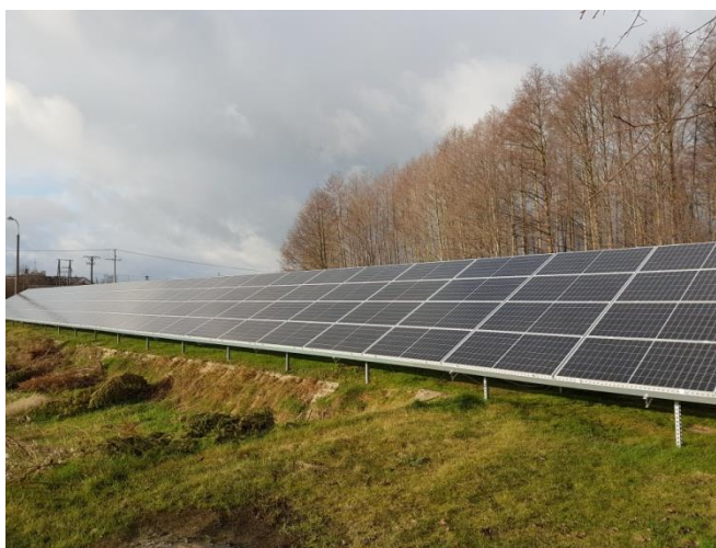
Instalacja fotowoltaiczna na oczyszczalni ścieków
